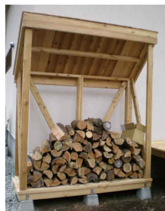
▲太陽熱給湯のタンクや薪の小屋に
